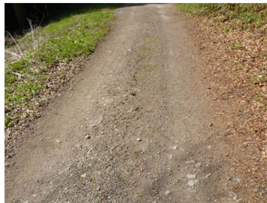
Abbildung: Verwitterter und genutzter Schotterweg
